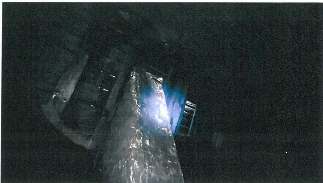
Fot. 22 – Liczne nieszczelności pokrycia, nieszczelny wylaz dachowy.
