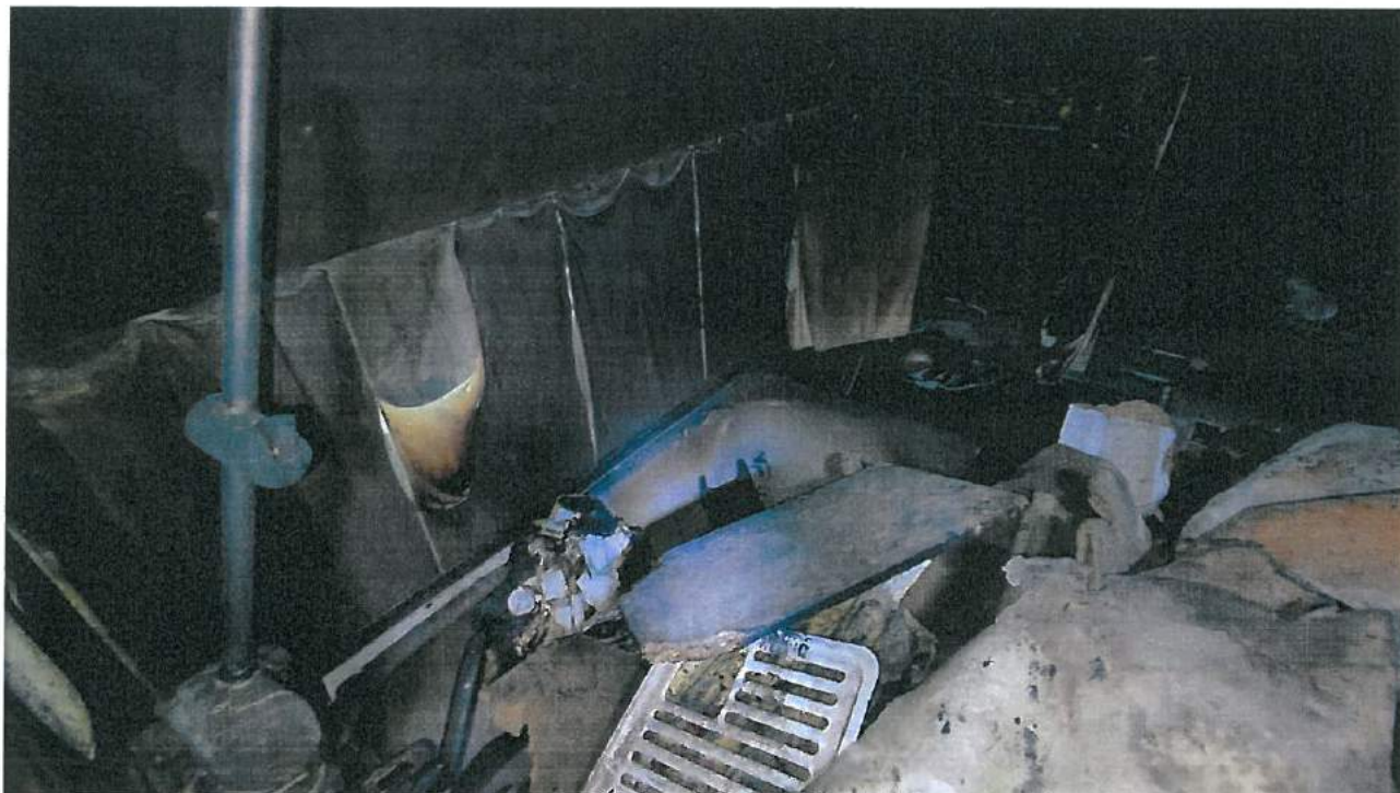
Fot. 28 – Uszkodzenia instalacji – wodno - kanalizacyjnych.
