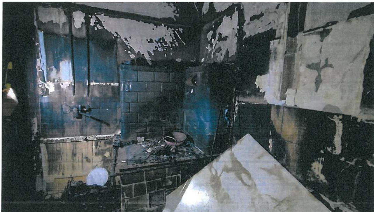
Fot. 8 – W pożarze mieszkania spaliły się okładziny a także wyposażenie i meble.
