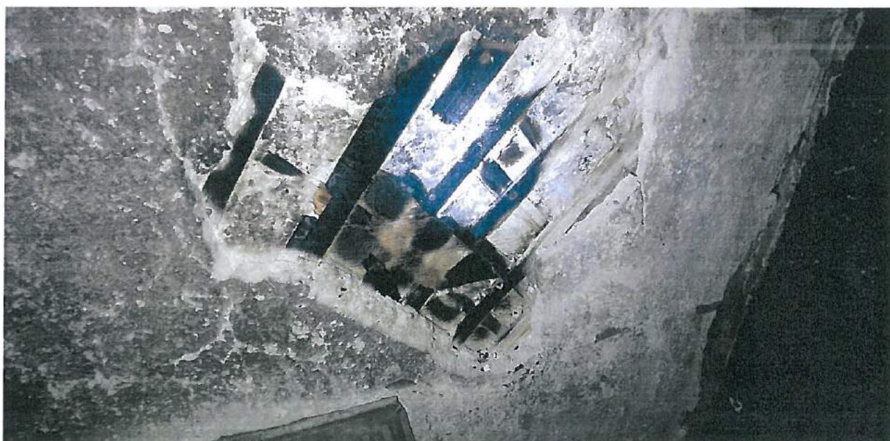
Fot. 27 – Uszkodzenia spalonych ścian działowych.
