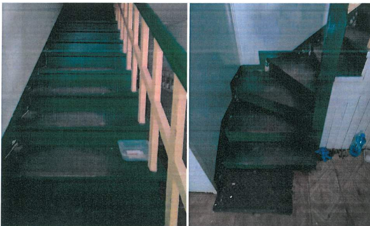
Fot. 23, 24 – Widoczne uszkodzenia mechaniczne i zużycie eksploatacyjne.
