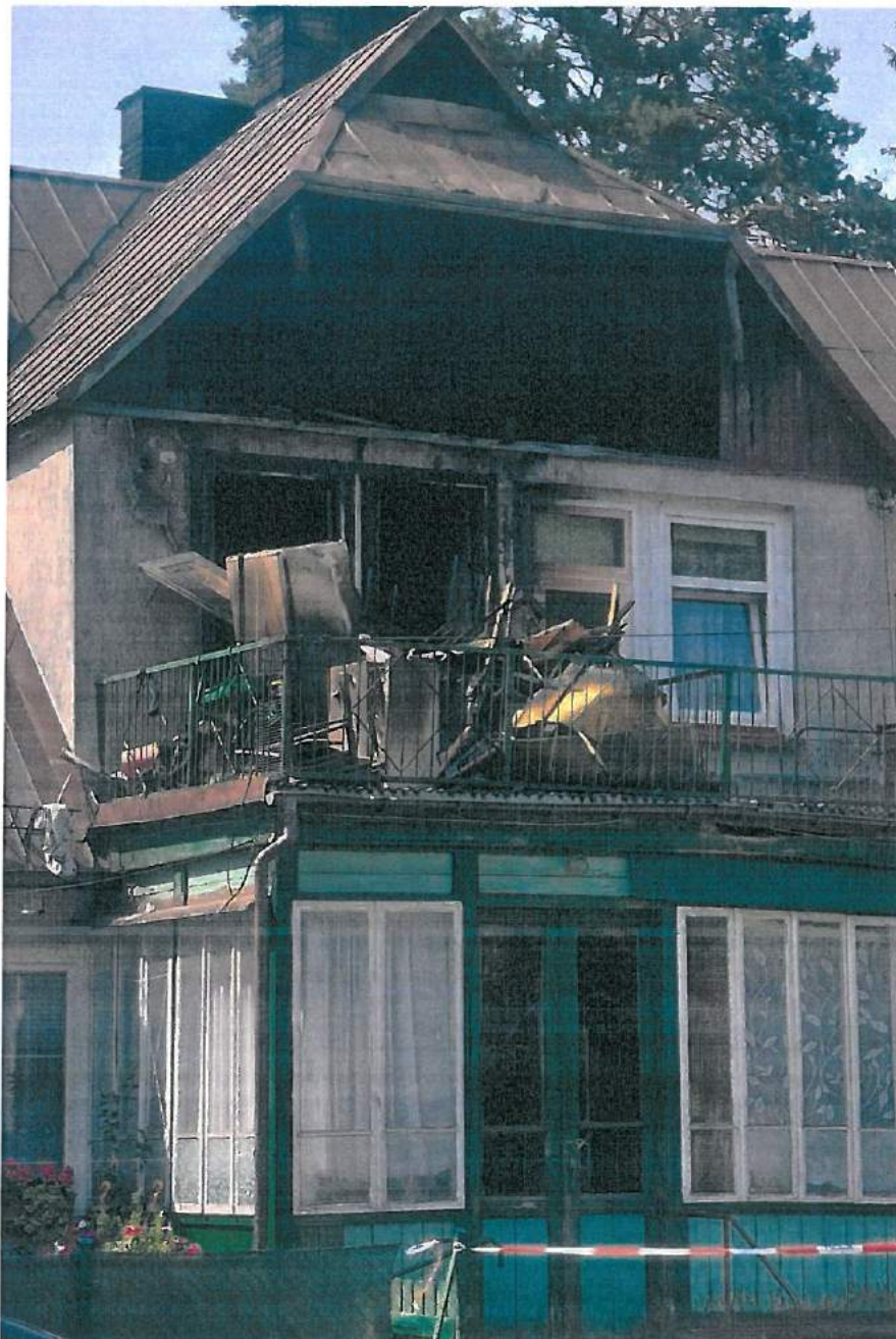
Fot. 25 – Stolarka uszkodzona w wyniku pożaru. Do wymiany.
