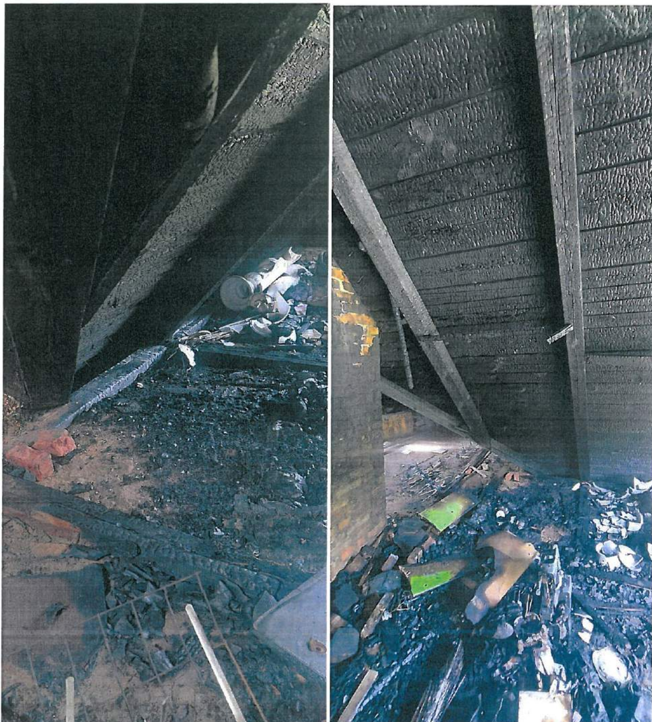
Fot. 13, 14 – Nadpalone belki stropowe, murlata oraz więźba.
