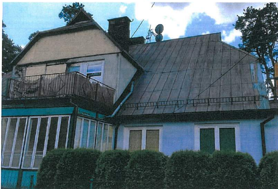
Fot. 26 – Widoczne uszkodzenia elewacji w skutek pożaru.
