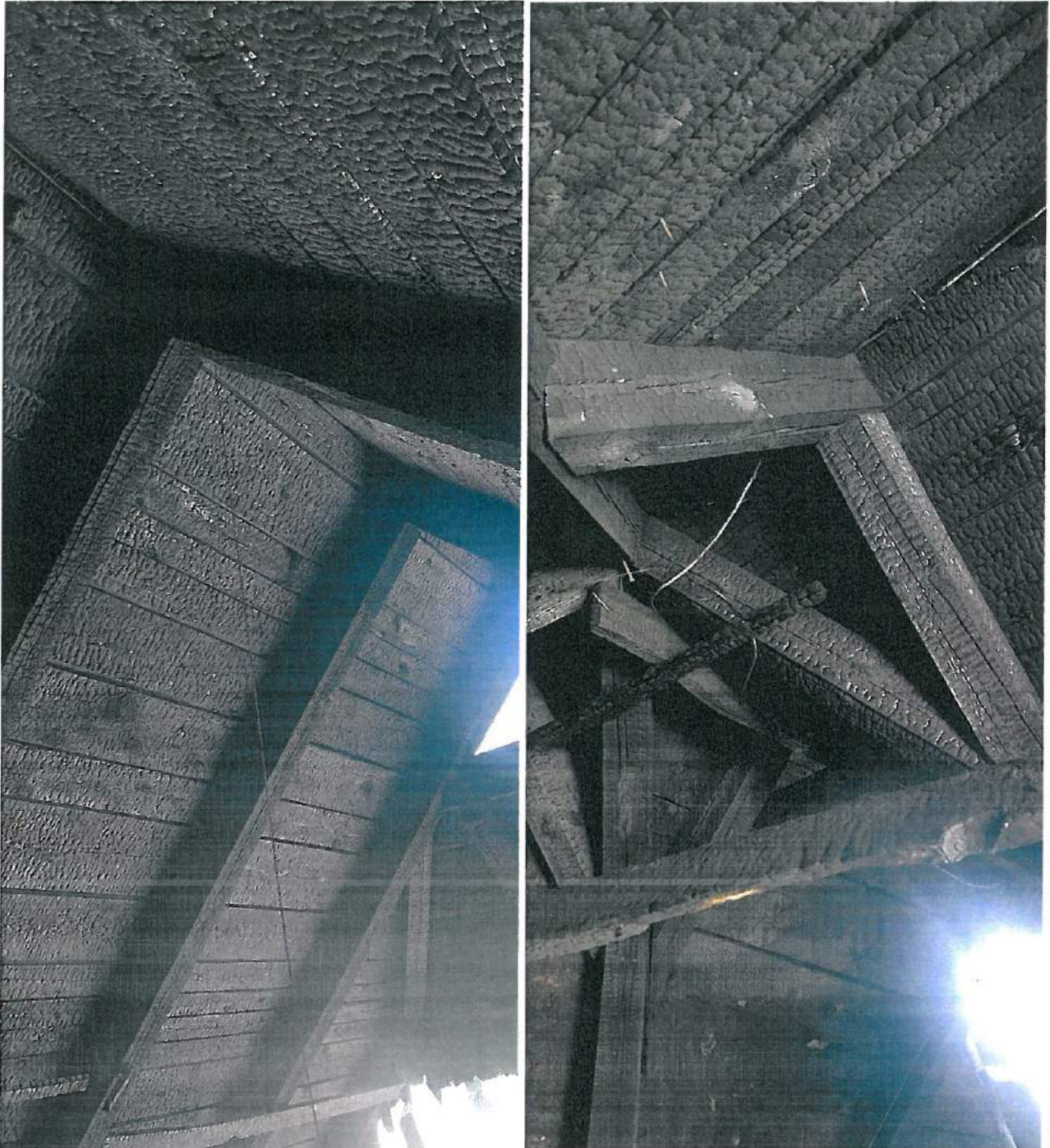
Fot. 11, 12 – Spalone krokwie, deskowanie oraz ściana szczytowa.
