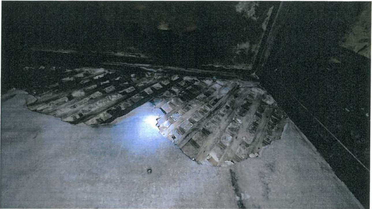
Fot. 9 – Uszkodzony, nadpalony ruszt ścian.
