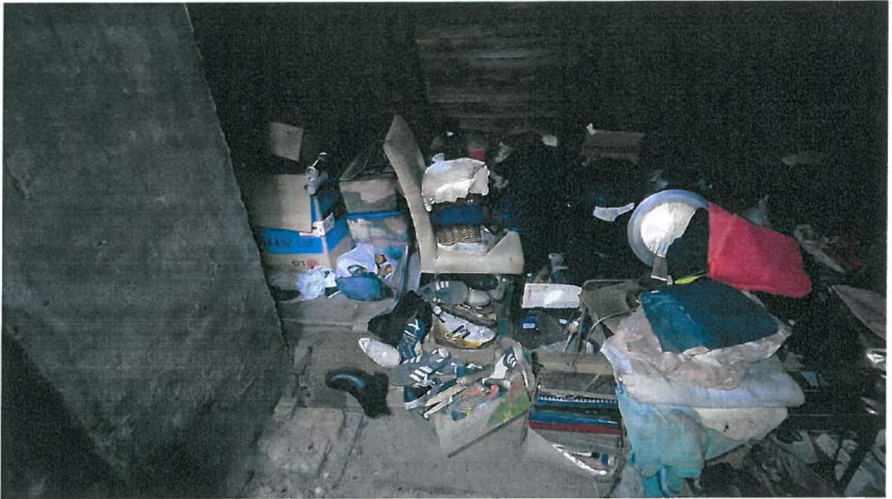
Fot. 17 – Na poddaszu nieużytkowym przechowywane są tekstylia i inne łatwopalne materiały w tym opakowania, buty, książki i zeszyty. Należy uprzątnąć przestrzeń stropu nad poddaszem użytkowym. Materiały te niepotrzebnie obciążają strop ale mogą też być przyczyną kolejnych pożarów.
