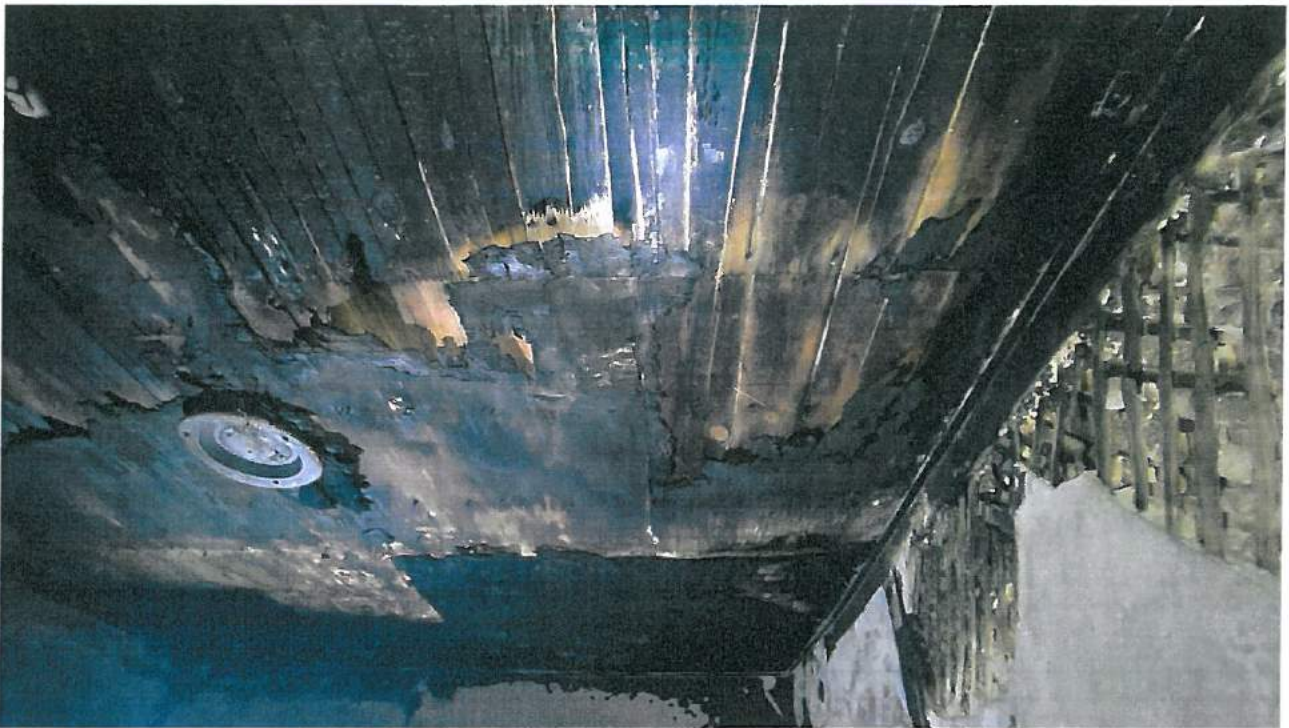
Fot. 6 – Uszkodzona konstrukcja stropu nad 1 piętrem – stan awaryjny – widoczne zwęglenie elementów drewnianych – poszycia stropu z desek. Zwęglenie sięga 10mm tj. 40% wysokości przekroju desek. Zabrania się jakiegokolwiek obciążania stropu w tej części poddasza.
