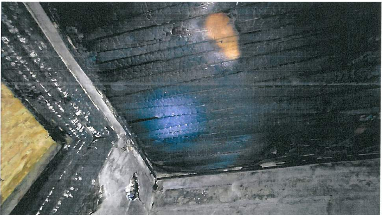
Fot. 7 – Najbardziej ucierpiała część konstrukcji stropu przy oknie ze względu na dopływ tlenu podczas pożaru oraz ściany zewnętrznej na poddaszu nieużytkowym, która doszczętnie spłonęła.
